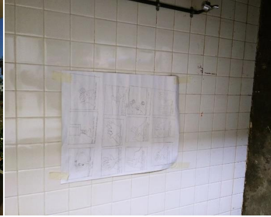
Cartel colocado en los baños del Preescolar
