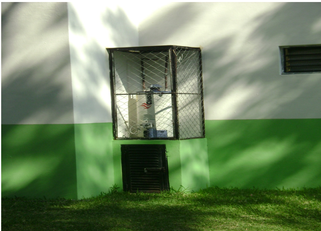
Boiler protegido por malla que se encuentra detrás del patio.
