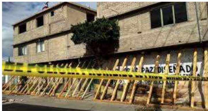
Foto 10.-Casas afectadas por el temblor del 19 de septiembre del 2017.
