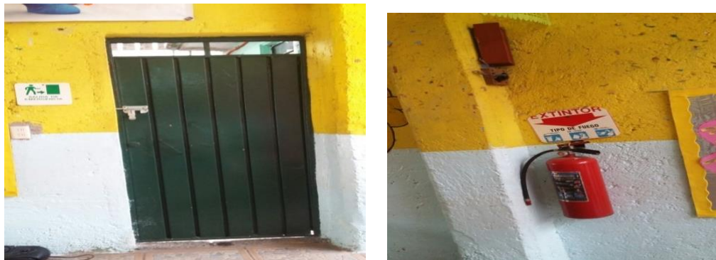
Salida de emergencia, extintor y alarma sísmica. Fuente: Propia.
