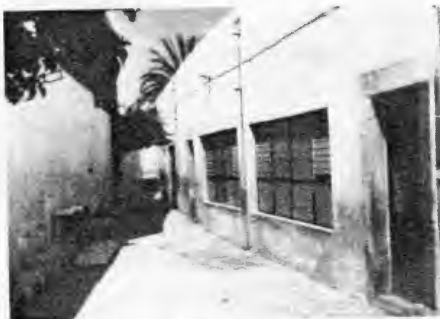
Aulas mal ventiladas e iluminadas de esta escuela.
