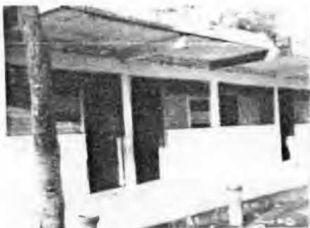
Aulas con altura no adecuada y además no terminadas.
