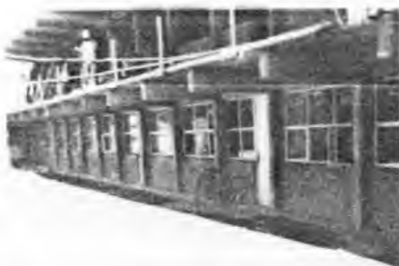
Aulas mal ventiladas e iluminadas de esta escuela.
