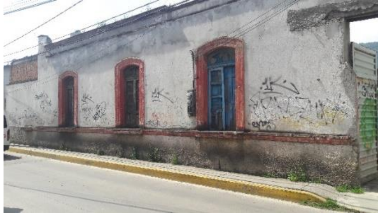
Imágenes de las casas y escuelas como estaban construidas anteriormente y que todavía existen. Después del temblor (2017) algunas de ellas fueron muy afectadas.
