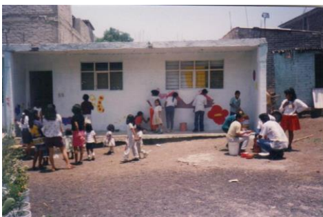
Primer salón en la calle Atlántida: Así se veía nuestro Centro infantil, en proceso de construcción
