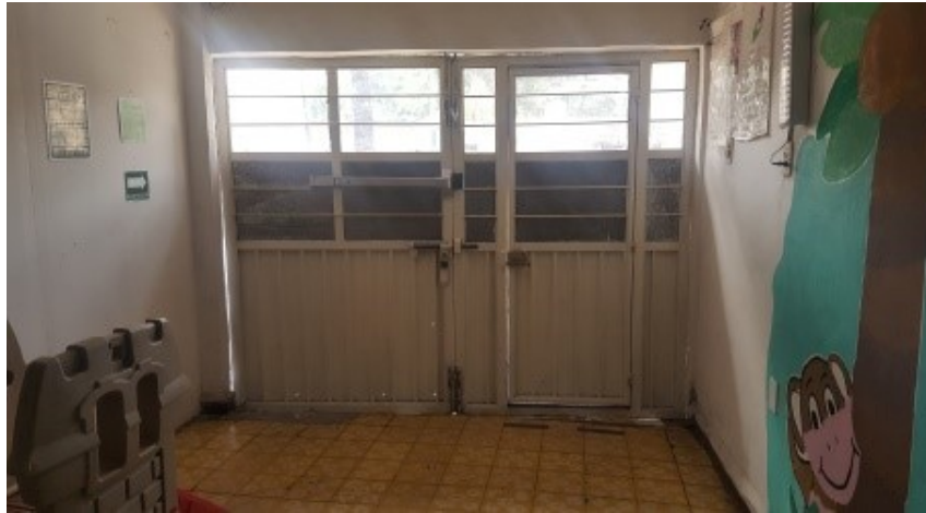
Foto 11: Salida de emergencia con barra de libre empuje Fuente: Propia
