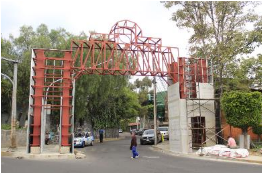
Imagen 43. Construcción del “Arco de Identidad” en el pueblo originario San Jerónimo Aculco- Lídice (Foto José Diego Gutiérrez Santos. Julio 2018)
