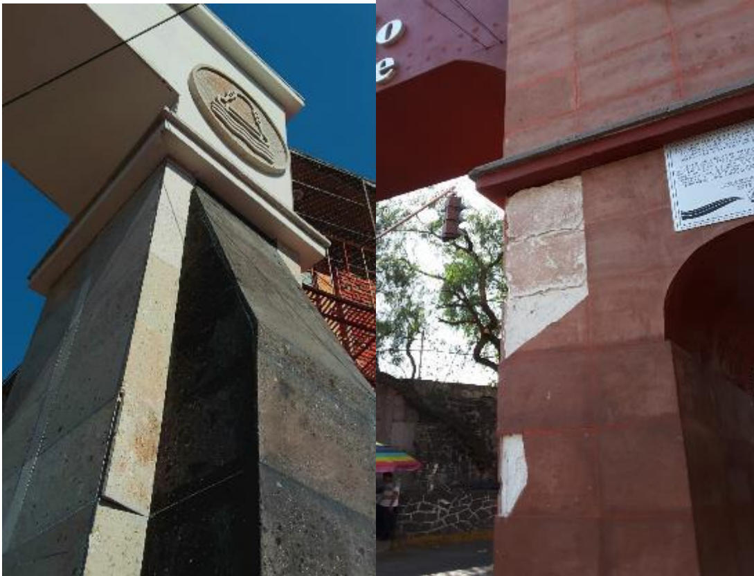
Imagen 45. Deterioros en los “Arcos de Identidad” de La Magdalena y de San Jerónimo respectivamente. (Foto José Diego Gutiérrez Santos. Enero 2019)
