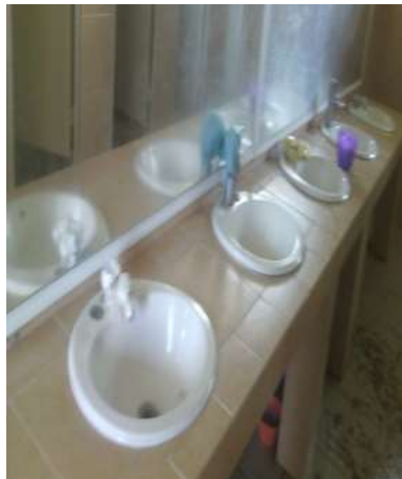
Lavabos en mal estado
