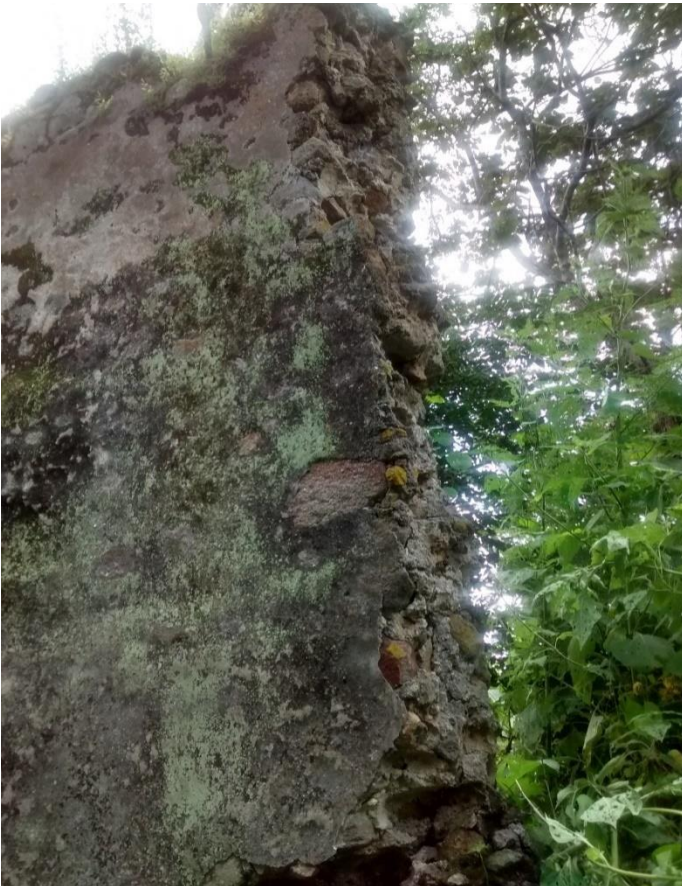
Fotografía 7 Pared 3 deteriorada. 5 de octubre de 2016. (Foto de Torres Hernández, J. L).
