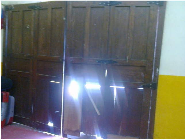
Figura 5. Instalaciones en mal estado del Centro Siglo XXI.
