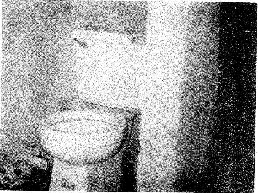
Falta de aseo y desinfección
