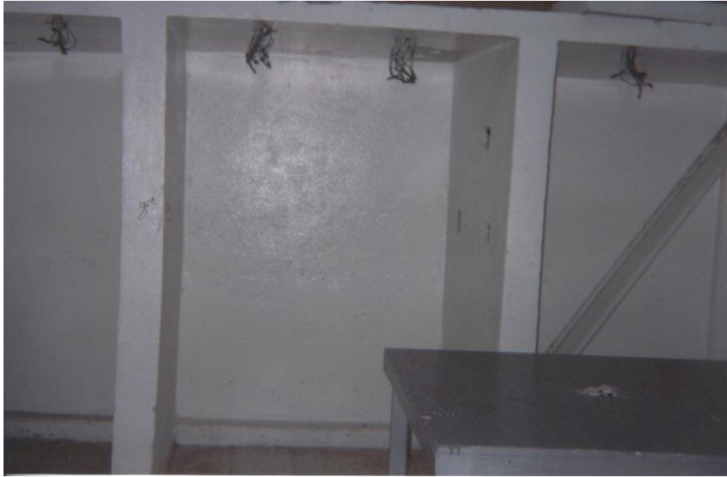
(Imagen 17) Casetas de Pràcticas de electricidad
