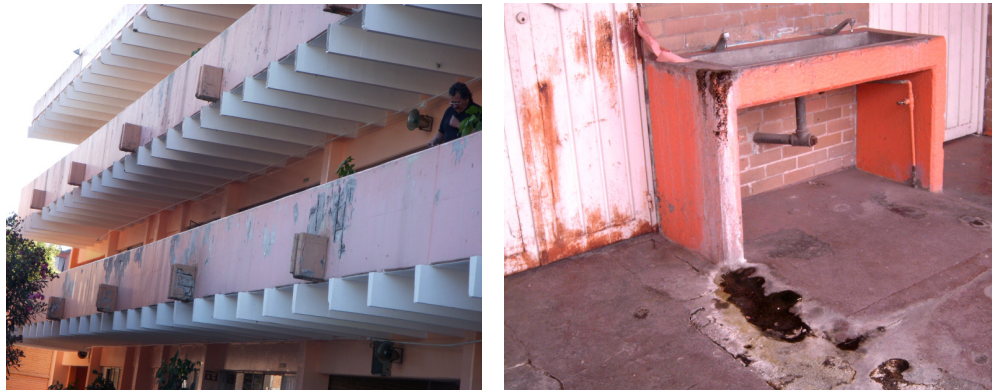
Muestras del deterioro en que se encuentra el edificio escolar
