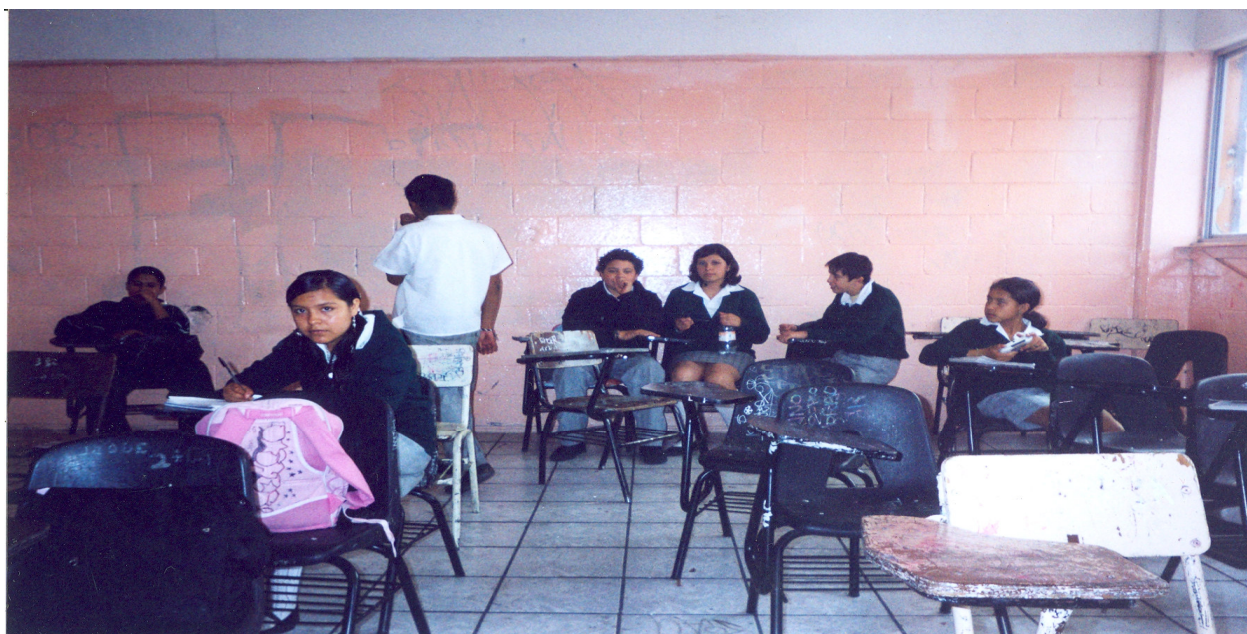
Algunas bancas presentan deterioro y en las paredes se puede observar la falta de respeto hacia el cuidado del salón de clases, como podemos observar en esta imagen la pared de atrás ésta pintado un graffiti.
