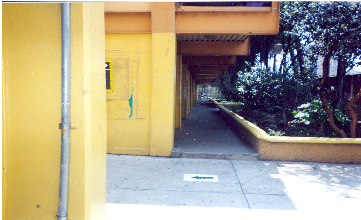
Este es el pasillo del edificio "A", aquí se alberga a los grupos de tercero y algunos salones se ocupan para los talleres. Al final del pasillo se observa el jardín que permanece cerrado por incidentes que ahí ocurrían.
