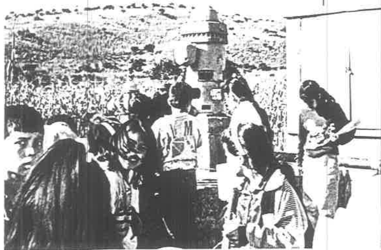
INSTALACIONES DEL POZO PROFUNDO.
